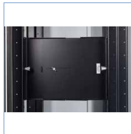
Paneles ciegos de adelante hacia atrás
