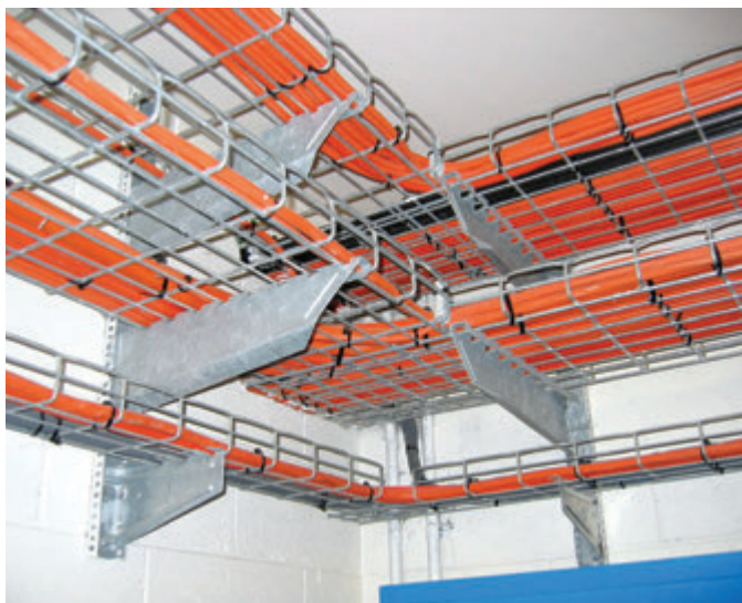
Ejemplo de espacio utilizado por un sistema de bandejas de cables.
