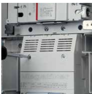
CUBIERTA AISLANTE INTERRUPTOR PRINCIPAL
